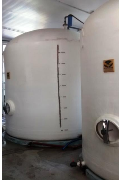
Imagen: cisternas de almacenamiento de agua potable
